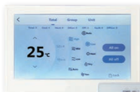
Центральный пульт управления QA-RPGC
